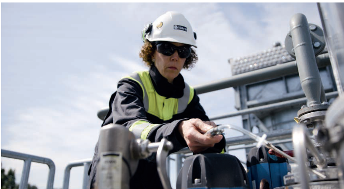
Mit einem Spezialgerät können geringste Methan-Emissionen aufgespürt werden, die aus Mikroleckagen entweichen. © Wintershall Dea
